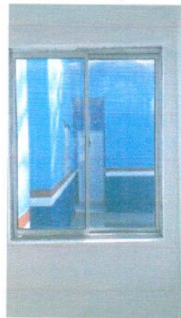
Foto 10 – Fecho da esquadria quebrado
