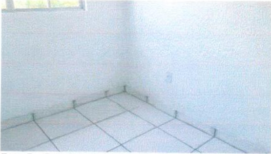
Foto 7 – Paredes sujas necessitarão de uma demão de tinta
