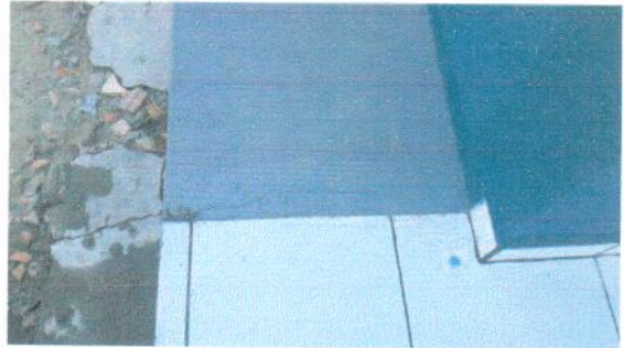
Foto 8 – Trincas nas calçadas
